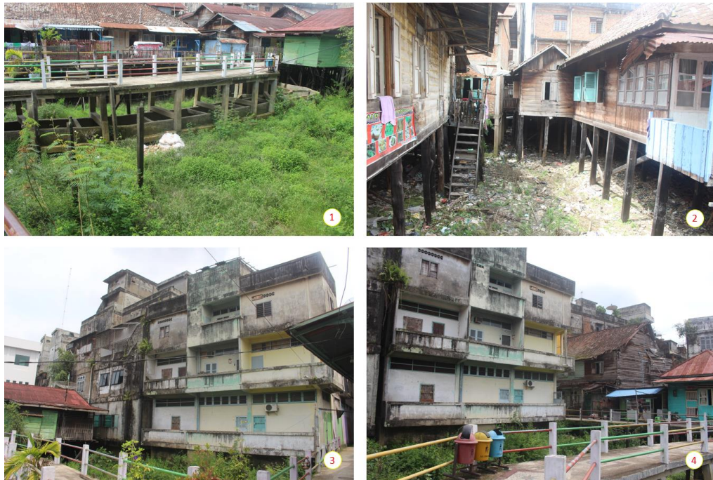
Gambar 2 Situasi dalam inti Blok A: (1) Rumah-rumah panggung kayu yang terhubung dengan titian panggung kayu yang sebagian besar sudah diganti dengan titian beton; (2) Kondisi rawa-rawa saat surut dengan meninggalkan sampah-sampah di bawah panggung rumah; (3) dan (4) deretan sisi belakang ruko tepi jalan yang membentuk dinding masif mengelilingi area.
